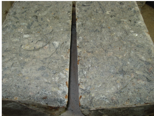
Figura 10 – Análise visual da situação das fibras de aço no interior do concreto.
