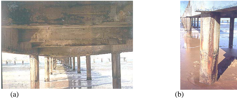
Figura 3 – Ataque característico devido à corrosão de armaduras em zona de variação de marés – (a) vista inferior da passarela da plataforma; (b) vista lateral dos pilares (Fotos: Maryangela Geimba de Lima, 1987).
